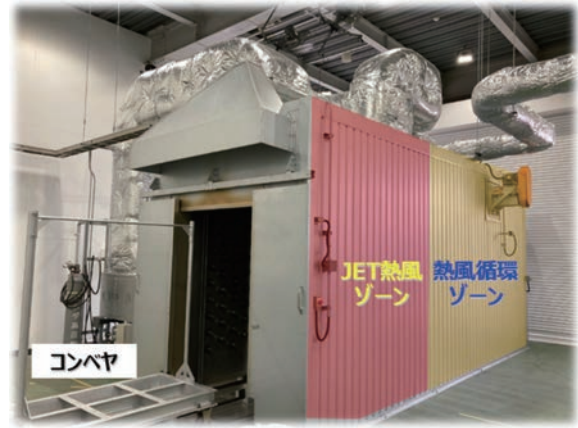
図7 HET ラボ乾燥炉外観
